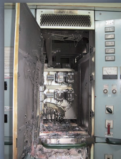
Internal Arc Fault 内部アーク短絡事故
