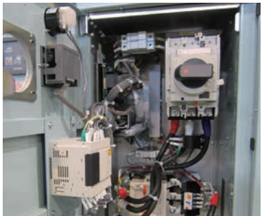
Unit inside wiring ユニット内配線
